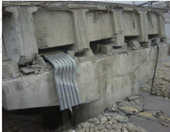
圖 3 橋梁斷裂導致實體線路斷裂
