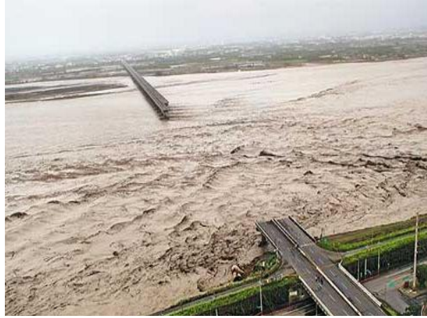
圖 2 大型天然災害中斷裂的橋梁
