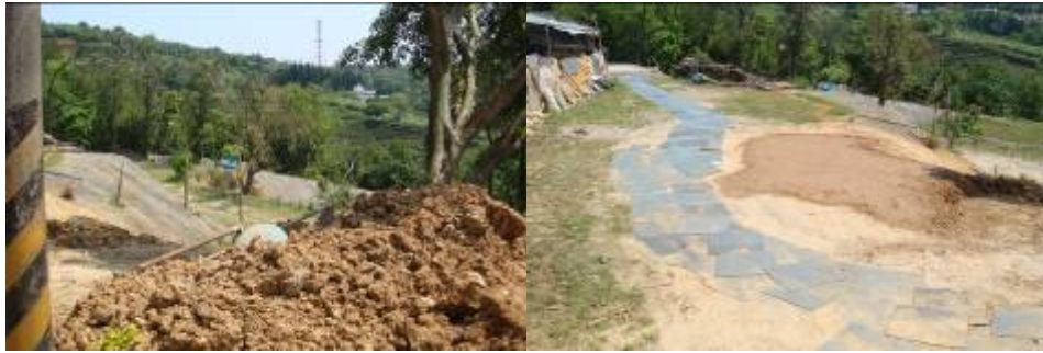
圖四：承租人擴建別墅施工中之廢土堆、遭剷平之山坡與水泥噴漿。
